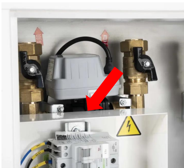
Rysunek 17: Miejsce wsunięcia czujnika temperatury (rozdzielnica jest zamontowana)
